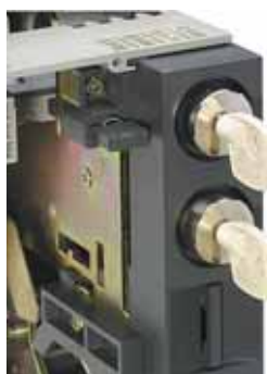
„Kiszakaszolva” helyzet reteszélése kulcsos zárral
